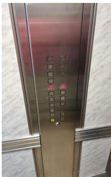
Zdjęcie nr 16: KOMUNIKACJA PIONOWA – winda (panel wewnętrzny)
