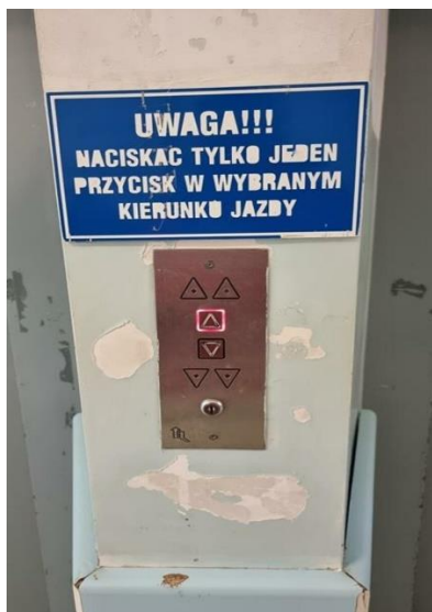
Zdjęcie nr 14: KOMUNIKACJA PIONOWA – winda (panel zewnętrzny)
